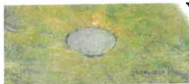
Dæksel på 425 mm sandfangsbrønd placeret før faskiner.
