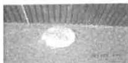
Tilslutningsbrønd for spildevand.
