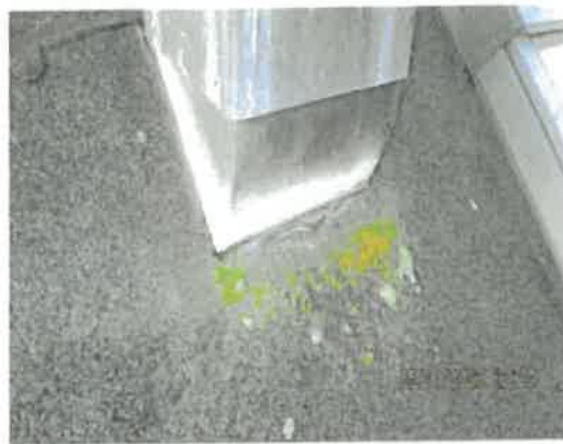
Krakeleret fuge omkring taghætte.
