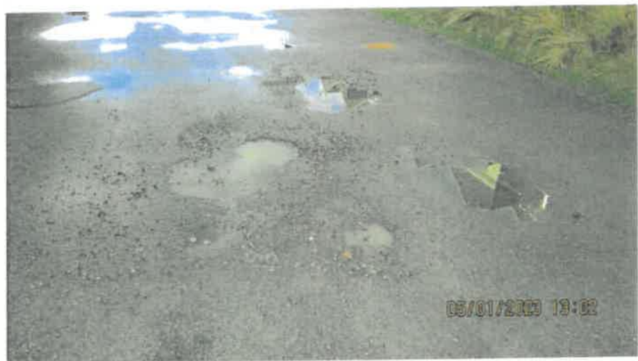
Asfaltbelægning med mange slaghuller langs Slusen 1-13
