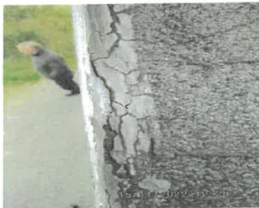
Krakeleret fuge langs vindskede.
