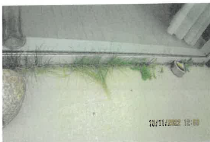
Græsvækst i fuger på betonterrasser fjernes.
