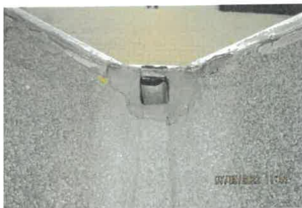
Eksisterende tagbrønd med provisorisk tætning med asfaltmasse.
