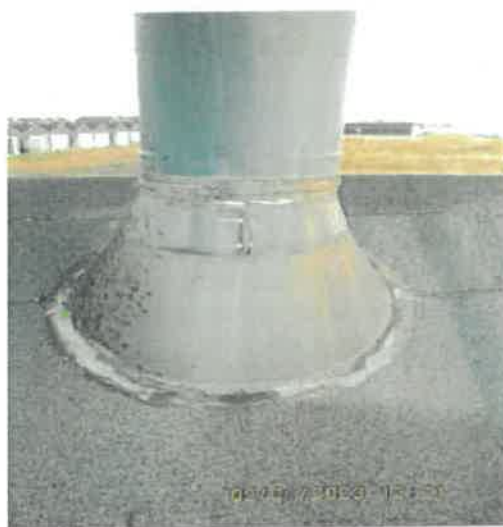
Krakeleret fuge omkring skorstensgennemføring.
